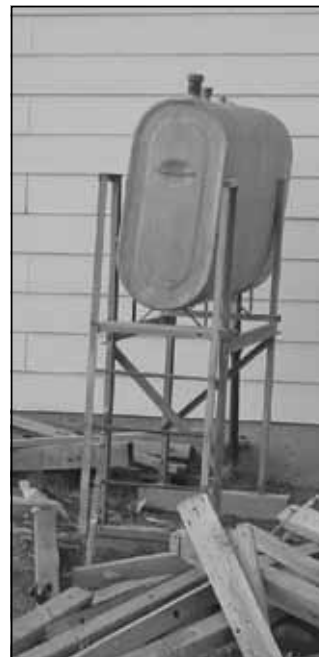
4.5a Une installation de réservoir instable : le support sur lequel le réservoir est installé n'étant pas ancré sur une base solide, le réservoir et son support penchent distinctement vers la droite. Un vent fort ou un impact mineur pourrait suffire à renverser le réservoir.
