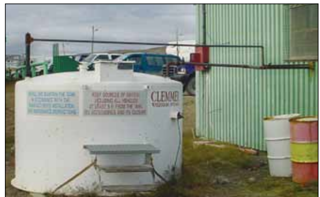
4.8 Ces conduits d'alimentation non consolidés — en particulier le conduit de retour (qui est le plus long) — fournissent aux enfants des grimpoirs faciles d'accès. Les résultats sont faciles à imaginer.
