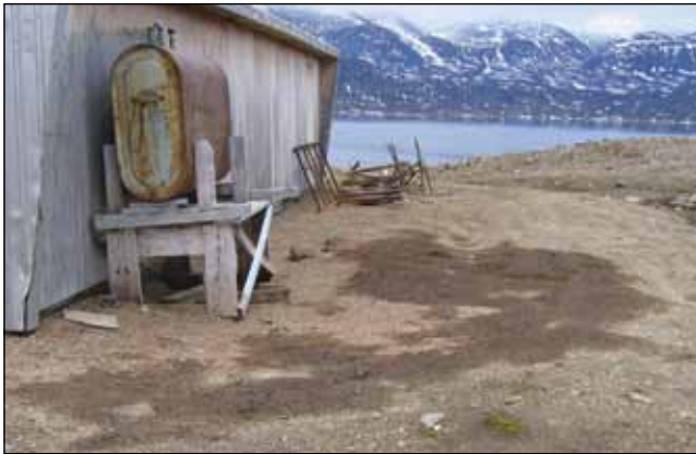
4.10 Sol gravement taché à cause d'une mauvaise installation et d'un entretien insuffisant du réservoir d'huile.
