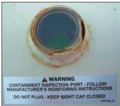
5.2c Hublot d'inspection d'un réservoir à double fond. Remarquez l'indicateur de couleur verte, qui vira au rouge en cas de fuite du plafond de double fond.
