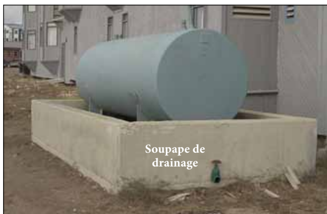
4.12 Un réservoir de 4 500 litres (1 000 gallons) doté d'une enceinte de confinement en béton. Notez que la soupape de drainage n'est pas pourvue d'un verrou ou d'une chaîne et qu'elle peut être trafiquée.
