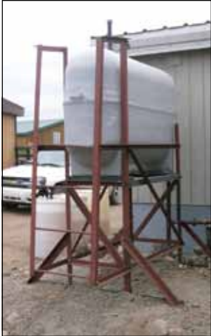
4.5c Remarquez la modification apportée au support. Le propriétaire a stabilisé la base métallique de son réservoir d'huile et ajouté des jambes de renfort à un angle de 45 degrés afin d'augmenter la solidité. Ainsi, la stabilité de l'installation est nettement supérieure à celle qu'offrait le support avant d'être modifié.
