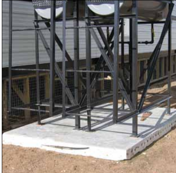
4.5d Une installation de réservoirs jumelés solidement fixés à un support de béton qui constitue une base solide.
