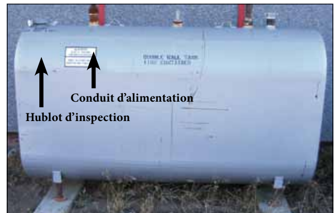
5.3 Réservoir d'huile de chauffage en acier à paroi double d'une capacité de 1 135 litres (250 gallons). Remarquez le hublot d'inspection situé sur la partie supérieure gauche du réservoir d'huile de chauffage.
