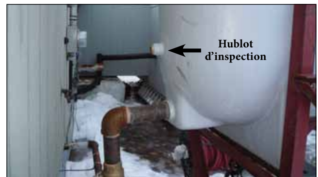
5.3b Hublot d'inspection d'un réservoir à paroi double en fibre de verre.
